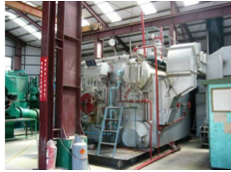
備註：水管式鍋爐
